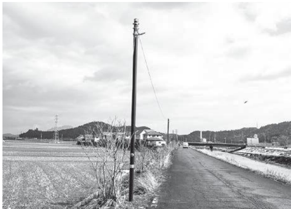
設置された防犯灯
