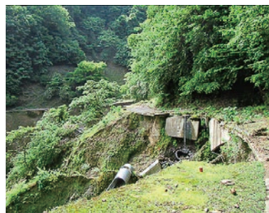
妻谷尾線被災状況
