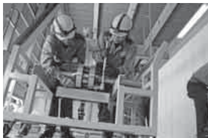
①冷却水配管の接続訓練
