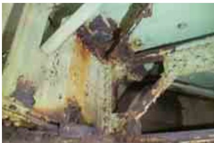
鋼橋の損傷状況 (国道8号 鳩原跨線橋)
